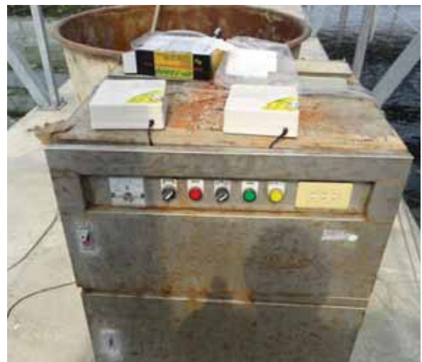
圖 4-6 具備不斷電系統的打氣機
