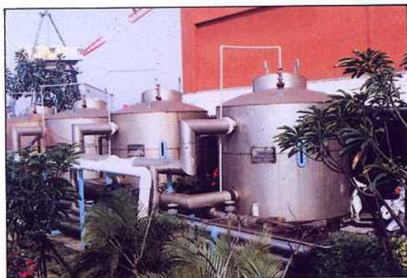
大型過濾槽--水質的守護神
