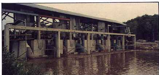
大型抽水站利用漲潮時大量抽水的情形
