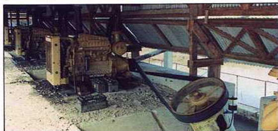
利用柴油引擎帶動抽水機抽水的情形
