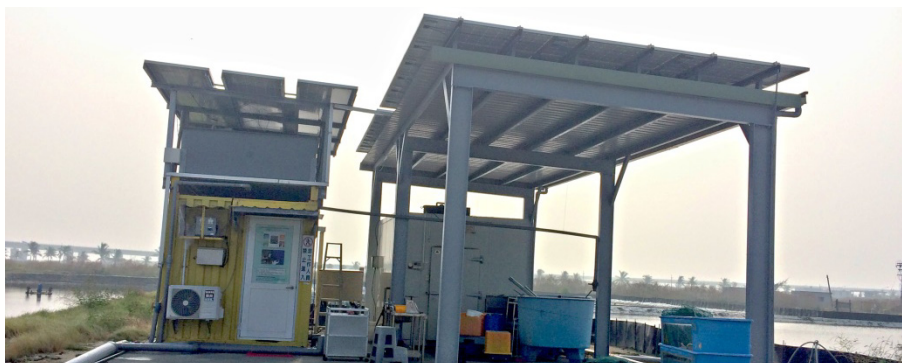
太陽能發電設備
