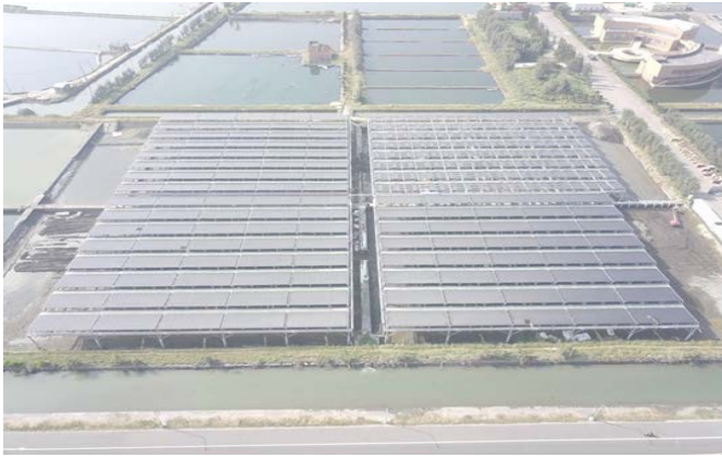
水試所海水繁養殖研究中心台西試驗場設置之立柱式太陽光電發電設備，裝置容量為1436kW
